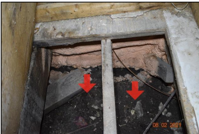
21. No vapor barrier
