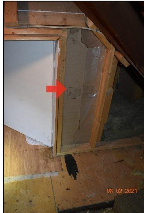
19. Gaps or voids
