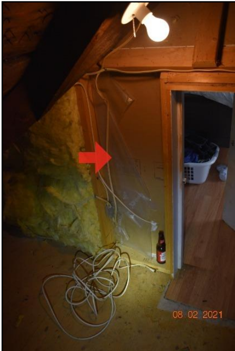
18. Gaps or voids
