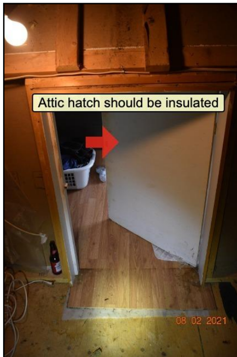
20. Gaps or voids
