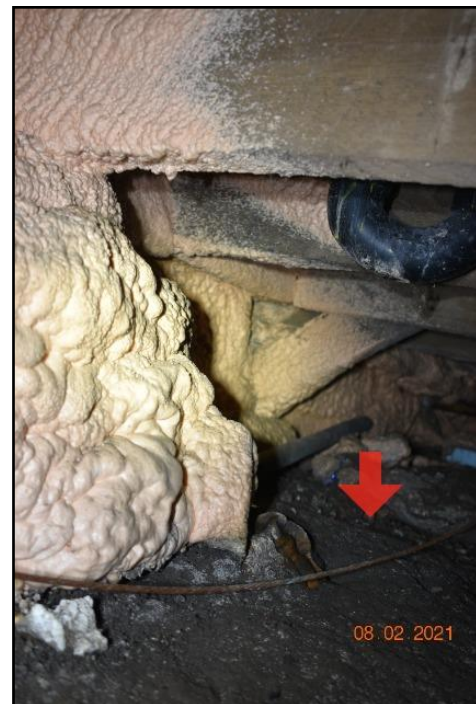
22. No vapor barrier
